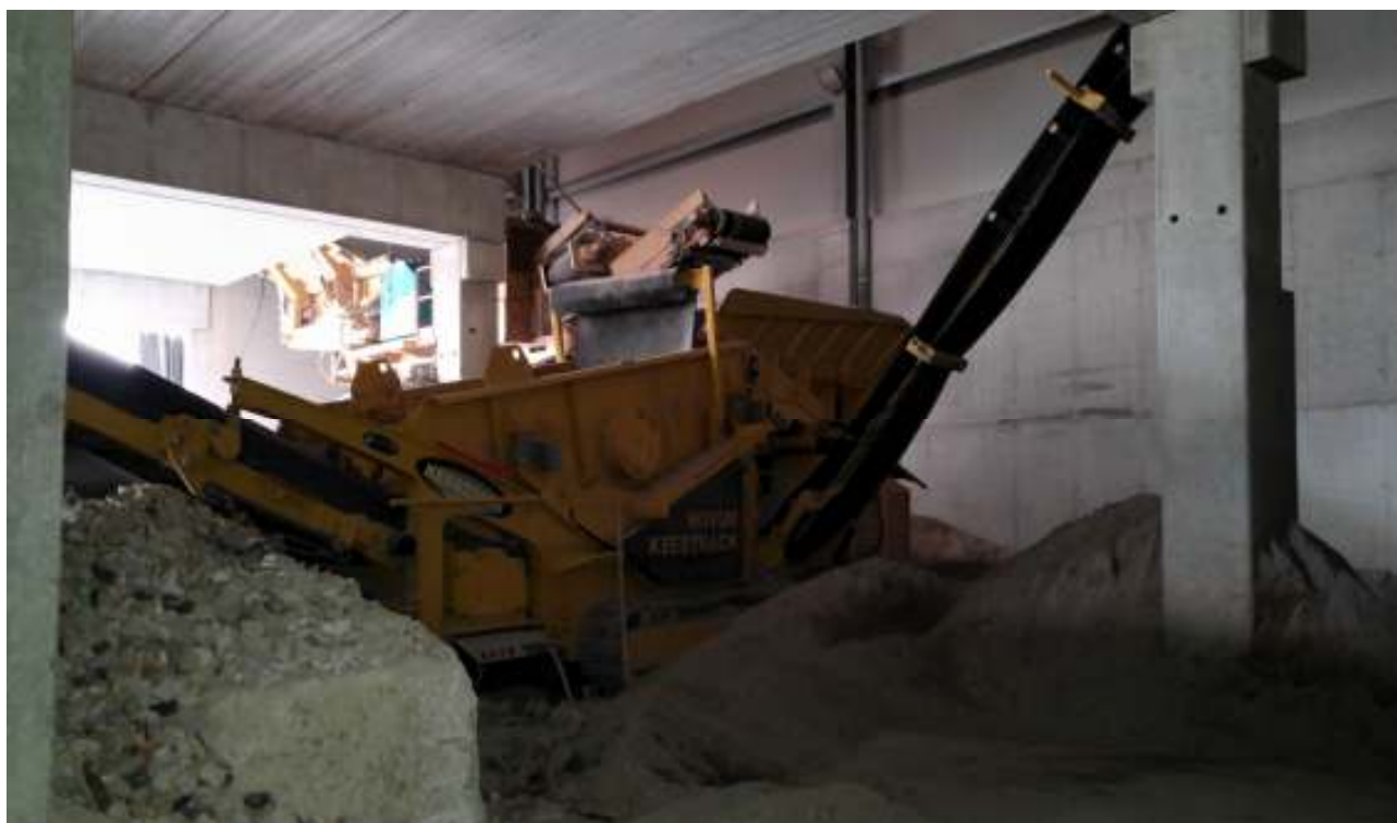
Figura 9: Immagine illustrativa dell'impianto di lavorazione della società SATIVA posto all'interno del capannone principale. (FONTE - Nuova Ecologia s.r.l. - aprile 2016)
