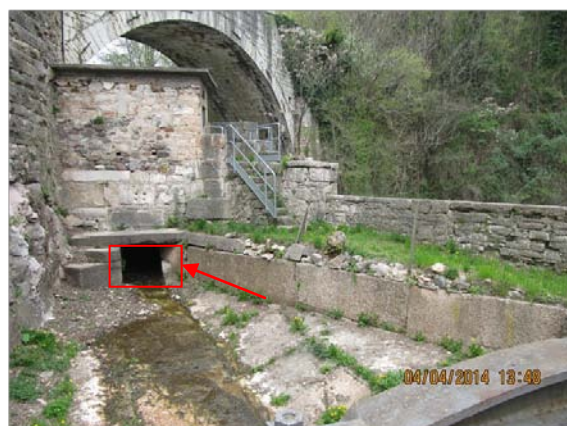
Figura 7 - Edificio sede della paratoia di presidio dell'opera di presa con indicazione della sezione di sbocco dall'opera di presa in vasca di calma.
