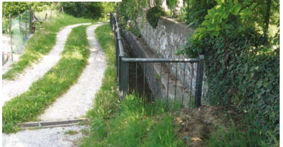
Barriera di protezione sul Rio Molini Località alla Grotta
