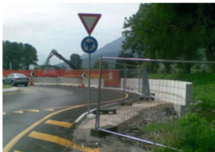
Via Sanseverino muro anti-esondazione.
