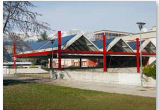
Impianto fotovoltaico all'Istituto Comenius
