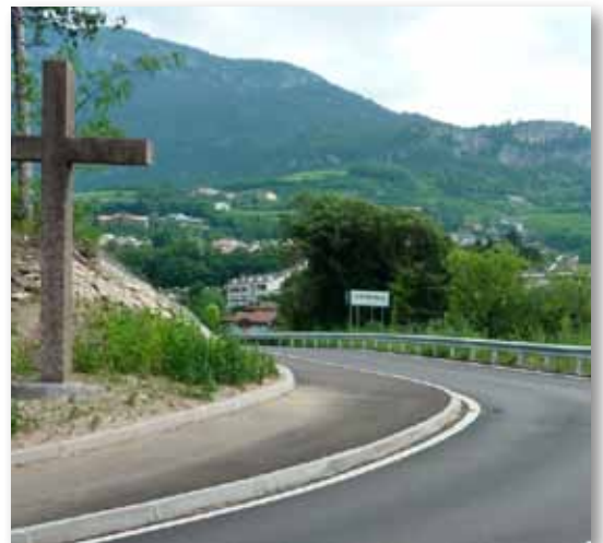
Terminati i lavori di rifacimento di un tratto di via alla Pelegrina a Cognola
