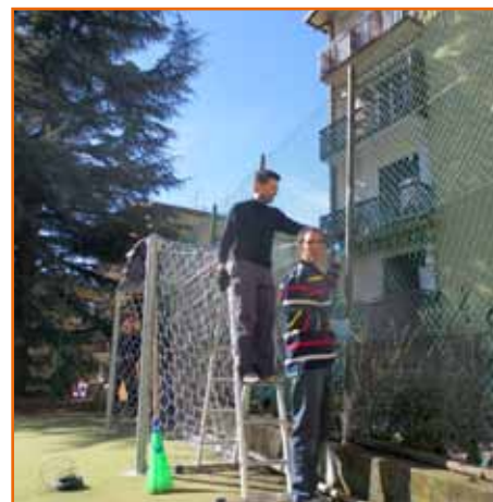
Si mette mano alla rete metallica che è stata rotta in vari punti
