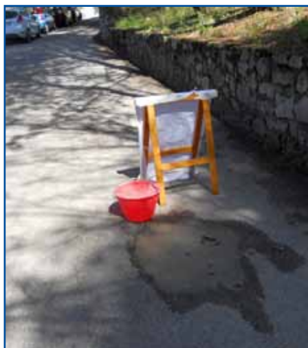
Laste - Altra buca sulla strada che ra un attimo pericolosa
