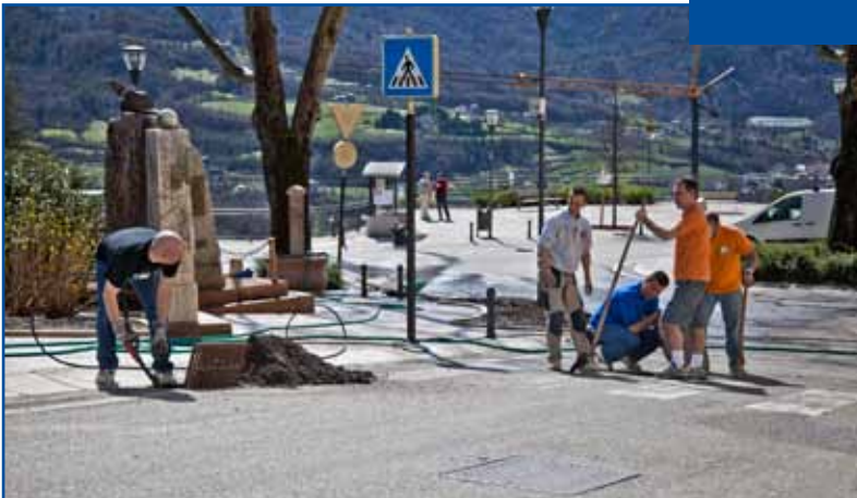
Carriolate di terra sono state rimosse dai tombini della piazza centrale
