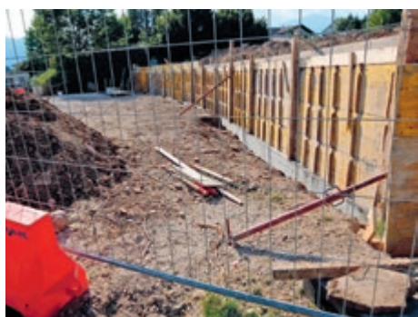
19.07.2016 Importanti lavori nel piazzale dell'asilo nido di Cognola, dietro il Centro Civico.
