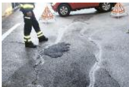
Cedimento del fondo stradale lungo via dei Segati
