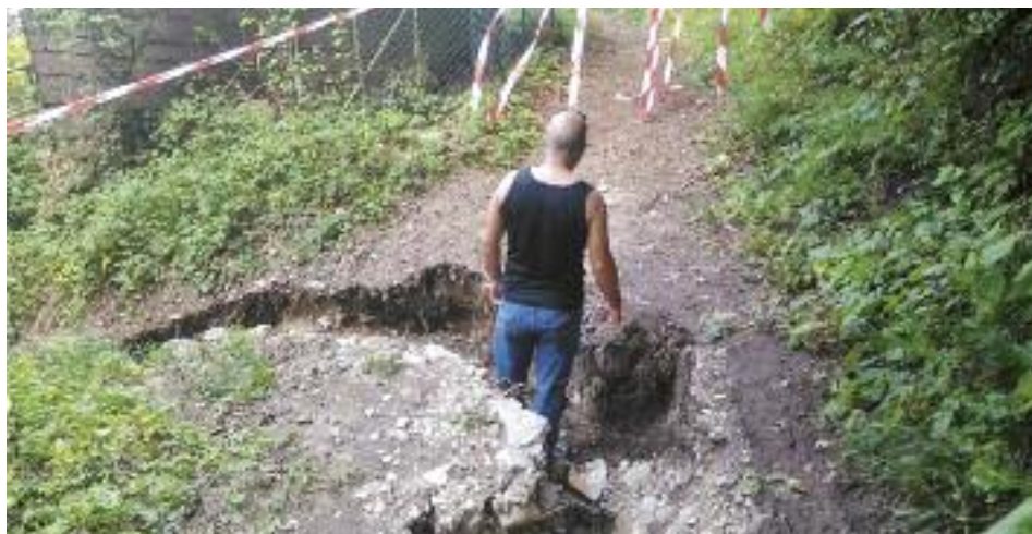
Notevole solco scavato dall'impeto delle acque
