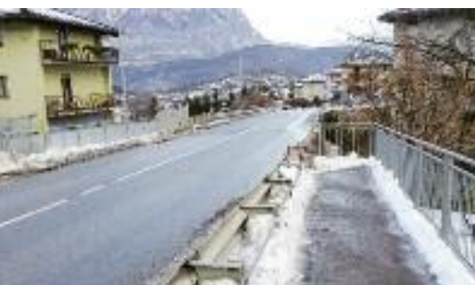
Tratto di marciapiede interrotto lungo Strada per Le Tre Cime
