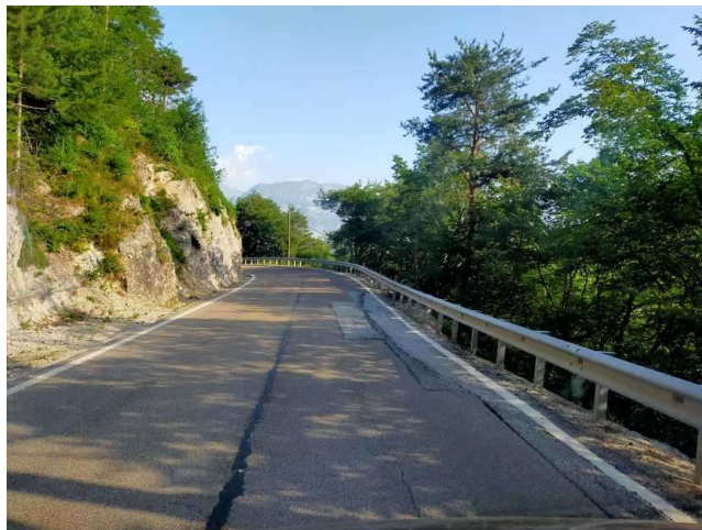
Foto 1: cedimenti già in atto ed in parte in passato sistemati in maniera provvisoria
