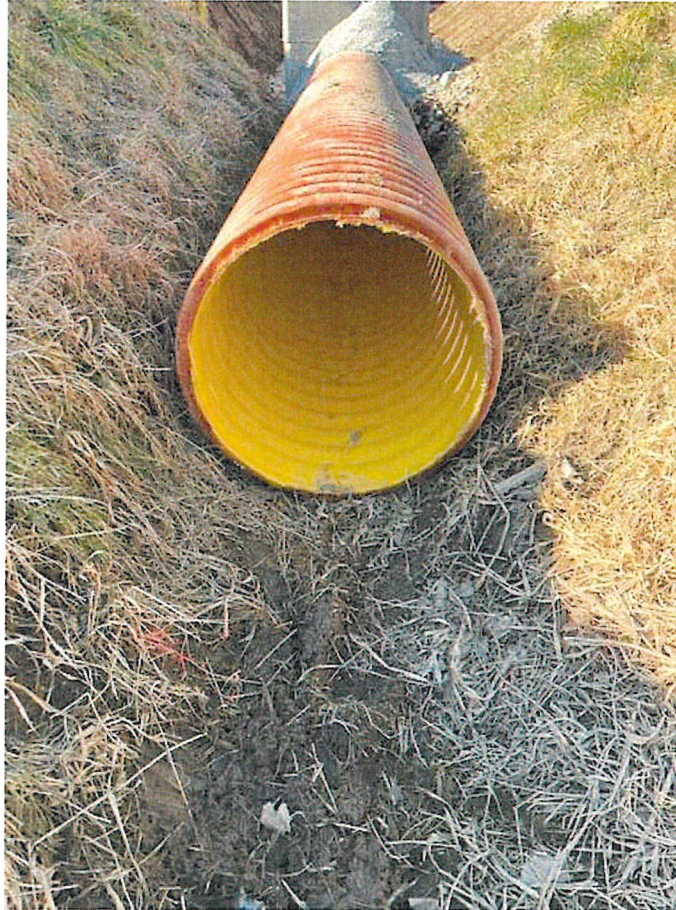
Foto 4: Particolare della tubazione di uscita a sud
