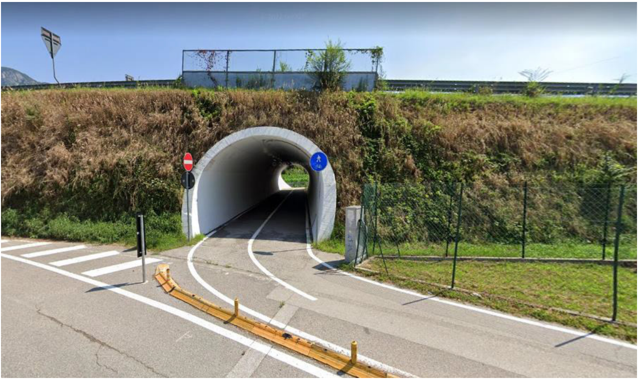
foto 3 - Assenza segnaletica orizzontale sottopasso
