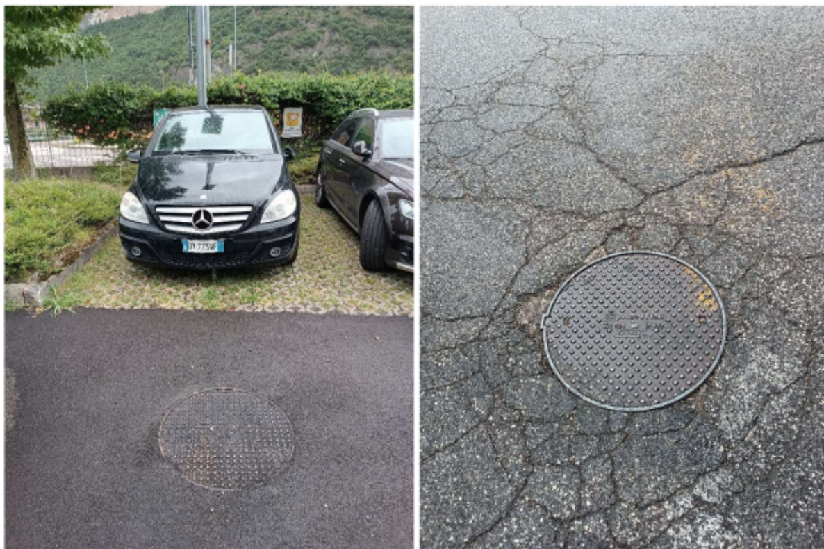
figura 9: Punti 1 e 2: Pozzetti di ispezione della Fossa.
